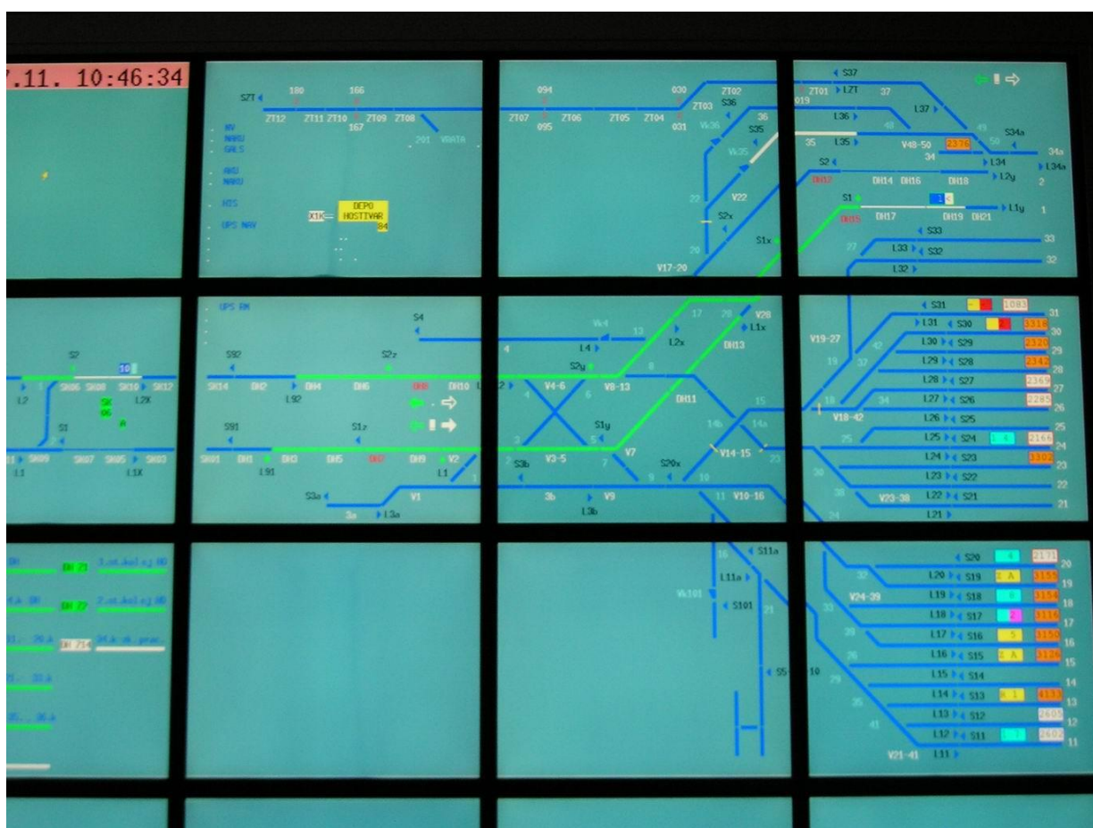
Obrázek 4: Staniční zabezpečovací zařízení ESA 11 M depa Hostivař 4
