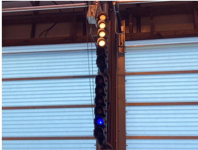
Fotografie 3: Testovací smyčka zabezpečovacího systému ARS
