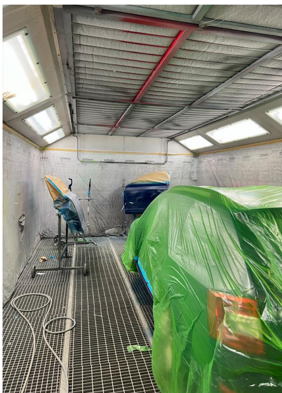
Fotografie 2: Lakovací kabina
