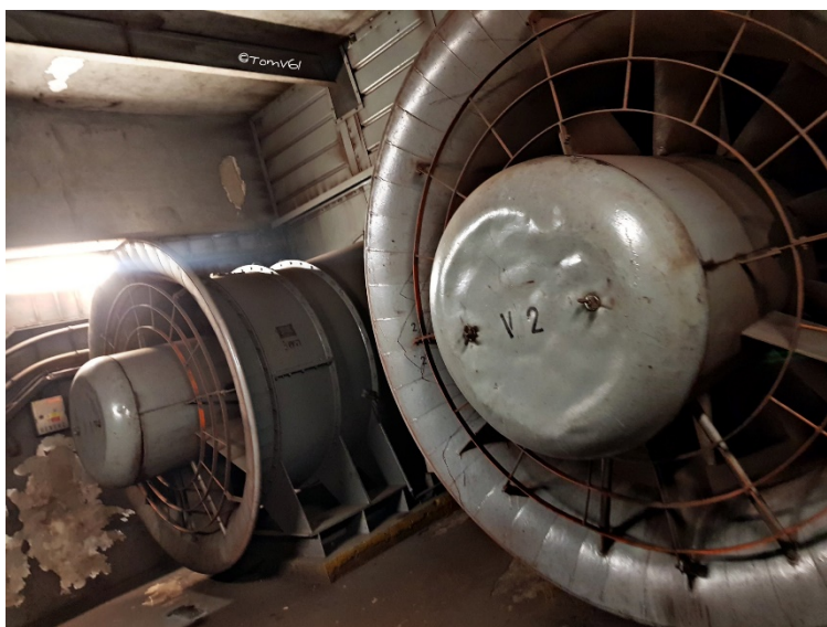
Foto 2 - Ventilátory hlavního větrání
