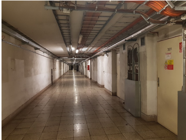
Foto 17 - Typické technické prostory stanice
