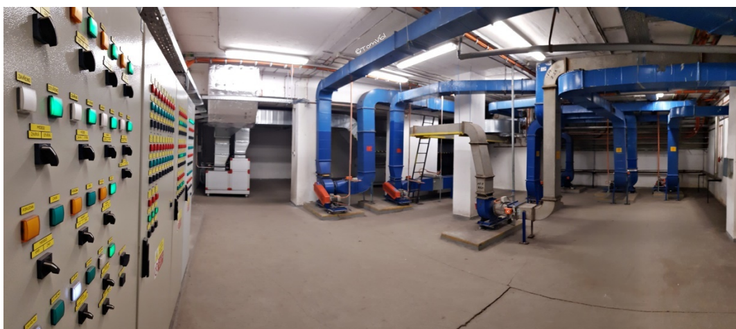
Foto 20 - Strojovna místní VZT
