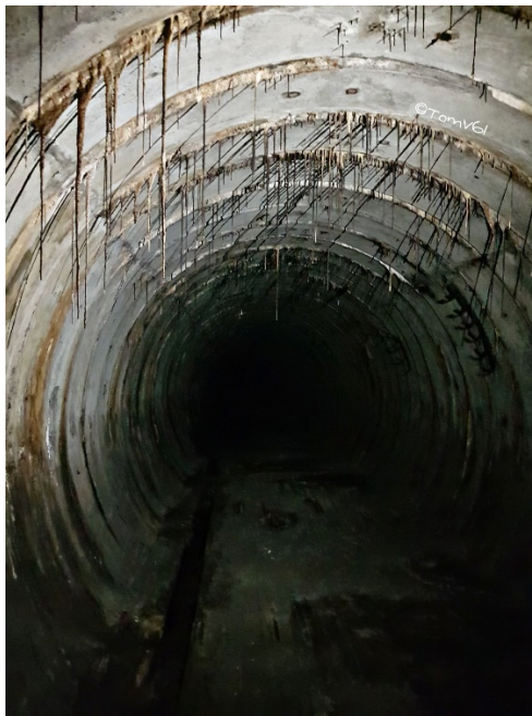
Foto 25 - 24 let opuštěná chodba
