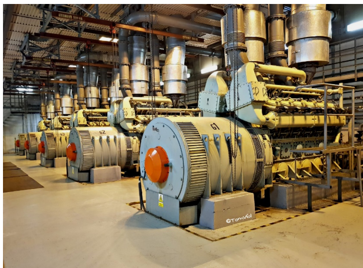
Foto 21 - Dieselagregáty s generátory
