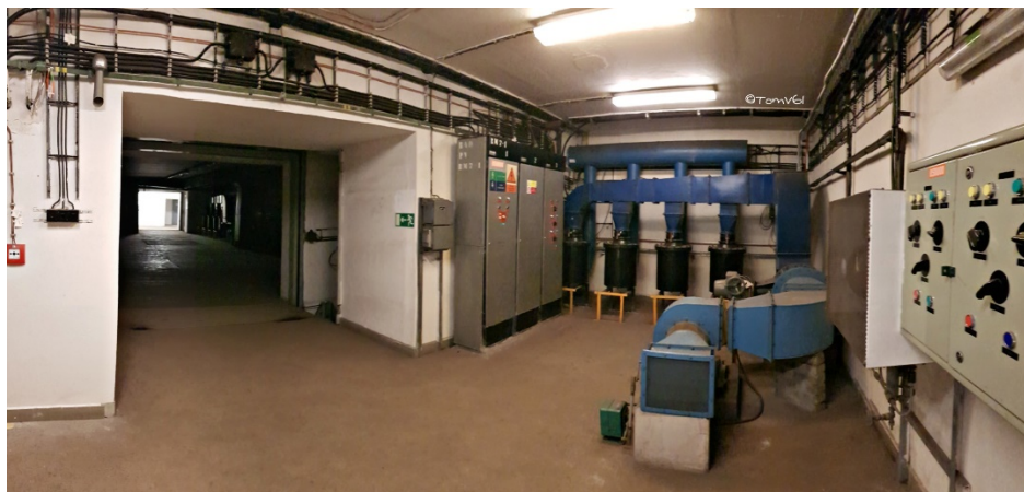
Foto 4 – KDV a vzduchové filtry
