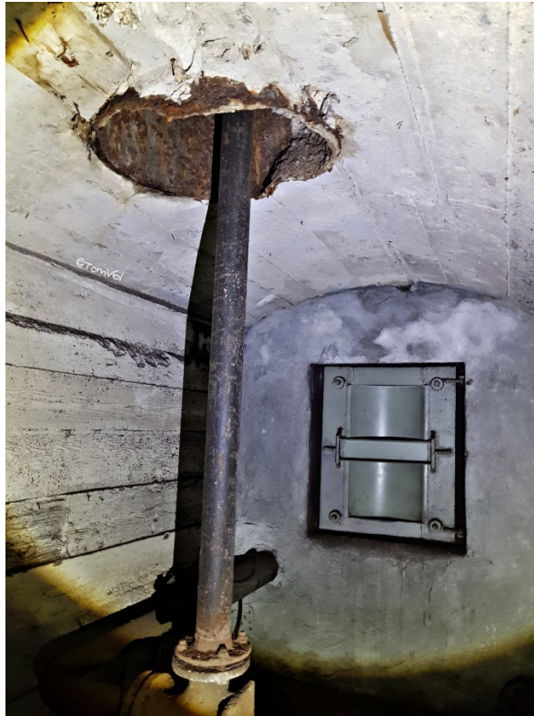
Příloha 7 - vrt z čerpací stanice oddělený uzávěrem P40
